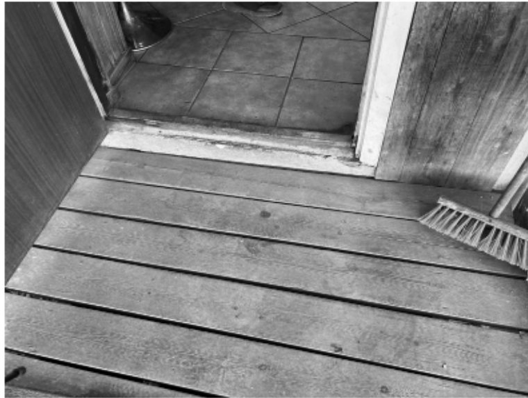
Tröskelparti vid balkongdörr. Trädäck utvändigt, klinker invändigt. Karm-understycke/ tröskel lossnade på plats under statusbesiktning.
