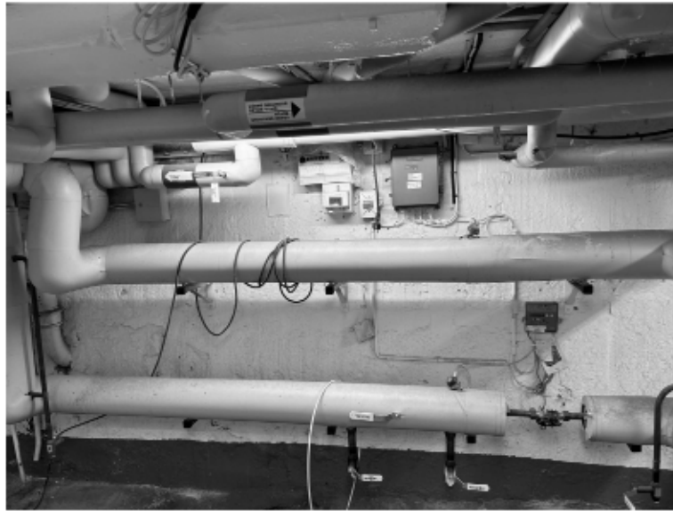
Fjärrvärme-UC i källare. Naval shuntventiler, energimätare, styrskåp. Stegringspump installerad ca 2010 noterades i kontinuerlig drift.
